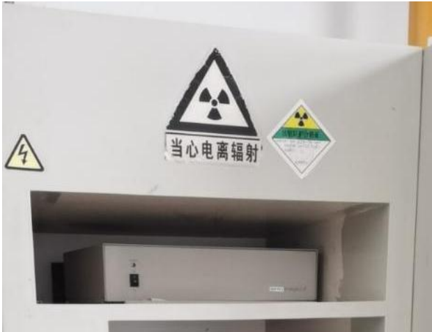
图 6 设备上电离辐射警告标志和中文警示说明
